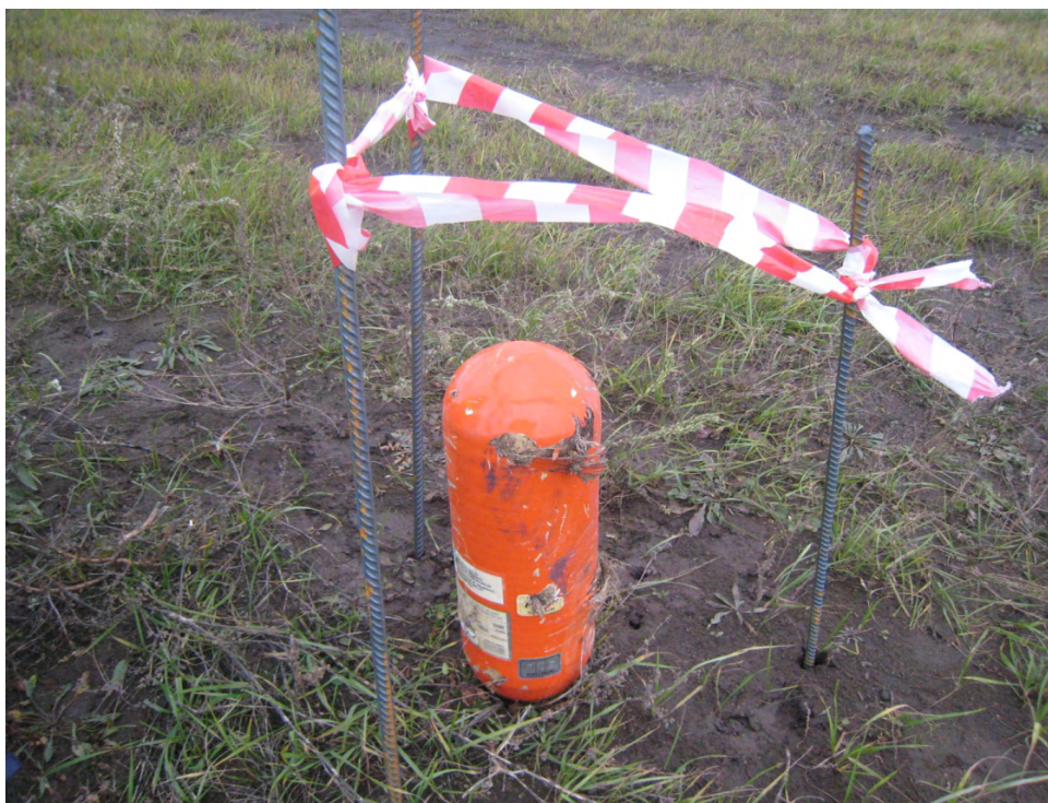
Рисунок 22. Баллон системы пожаротушения
