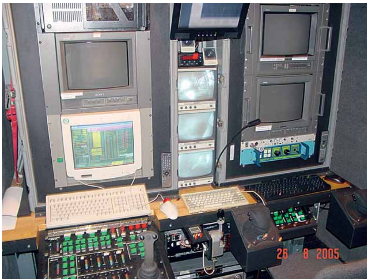
Foto 46: sala controllo Remora 6000.
